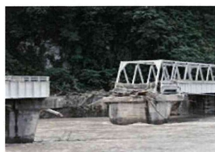
流失した人吉市県道15号西瀬橋
